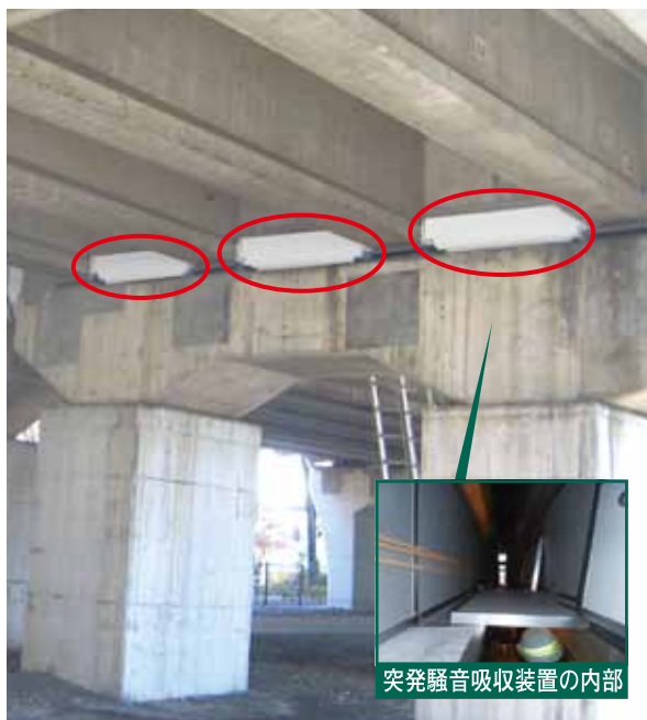
突発騒音吸収装置
